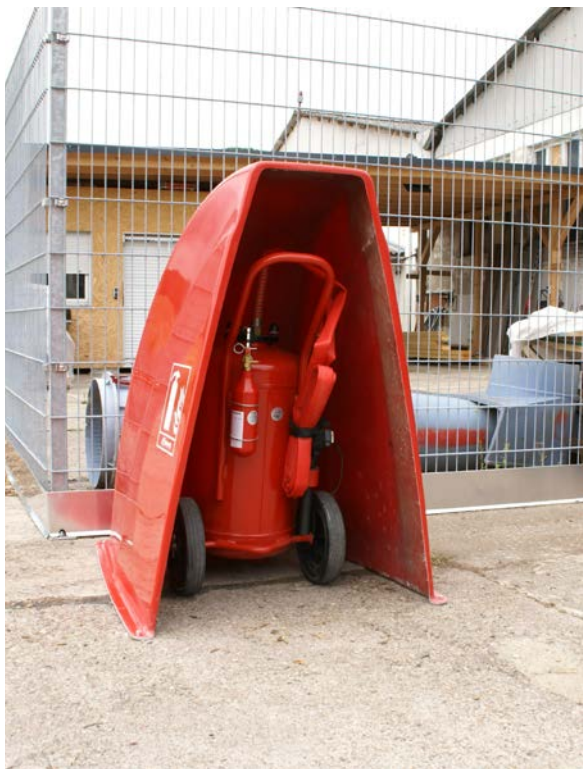
Unterstand mit Feuerlöscher
